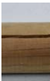
Cracks/Grietas/Fente/ Risse/Crepe/ Barsten/ Fendas
